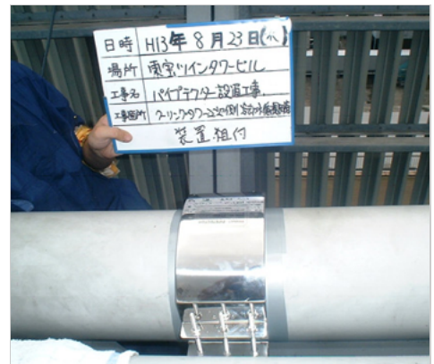
クーリングタワー二次側冷却水配管 PT-200DS
